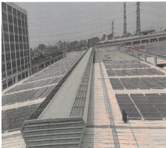
光伏发电设备
